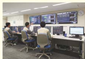
エネルギーセンター の中央監視室※
